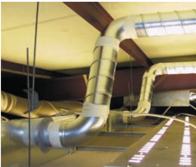
Bild 7 Anschluss der Luftdurchlässe im Deckenhohlraum
